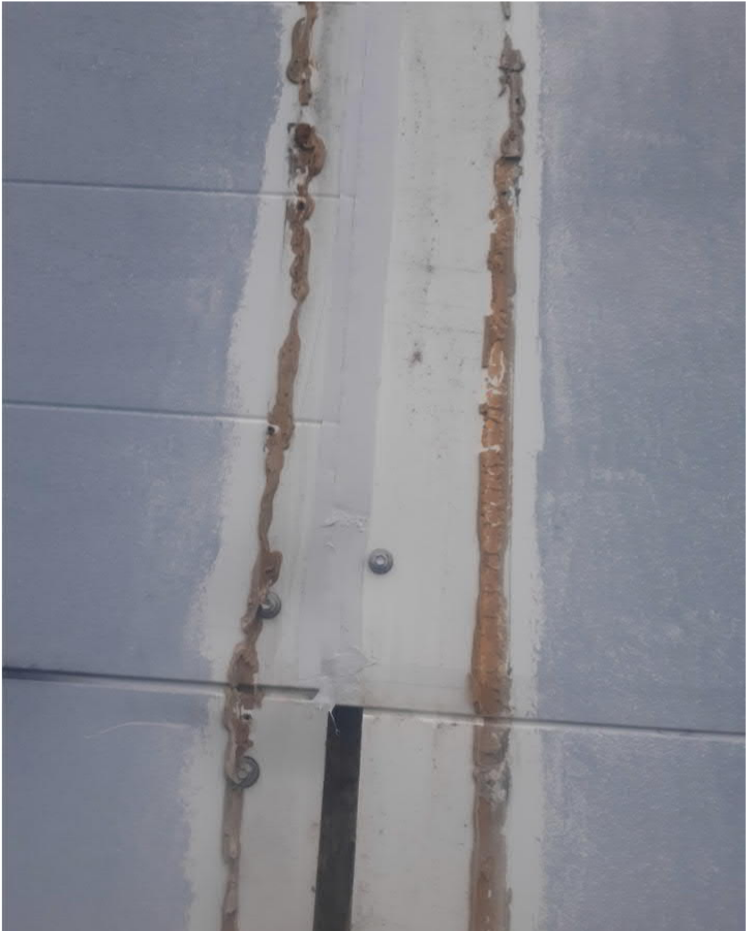
Korjattu elementtisauma 1.jpg
