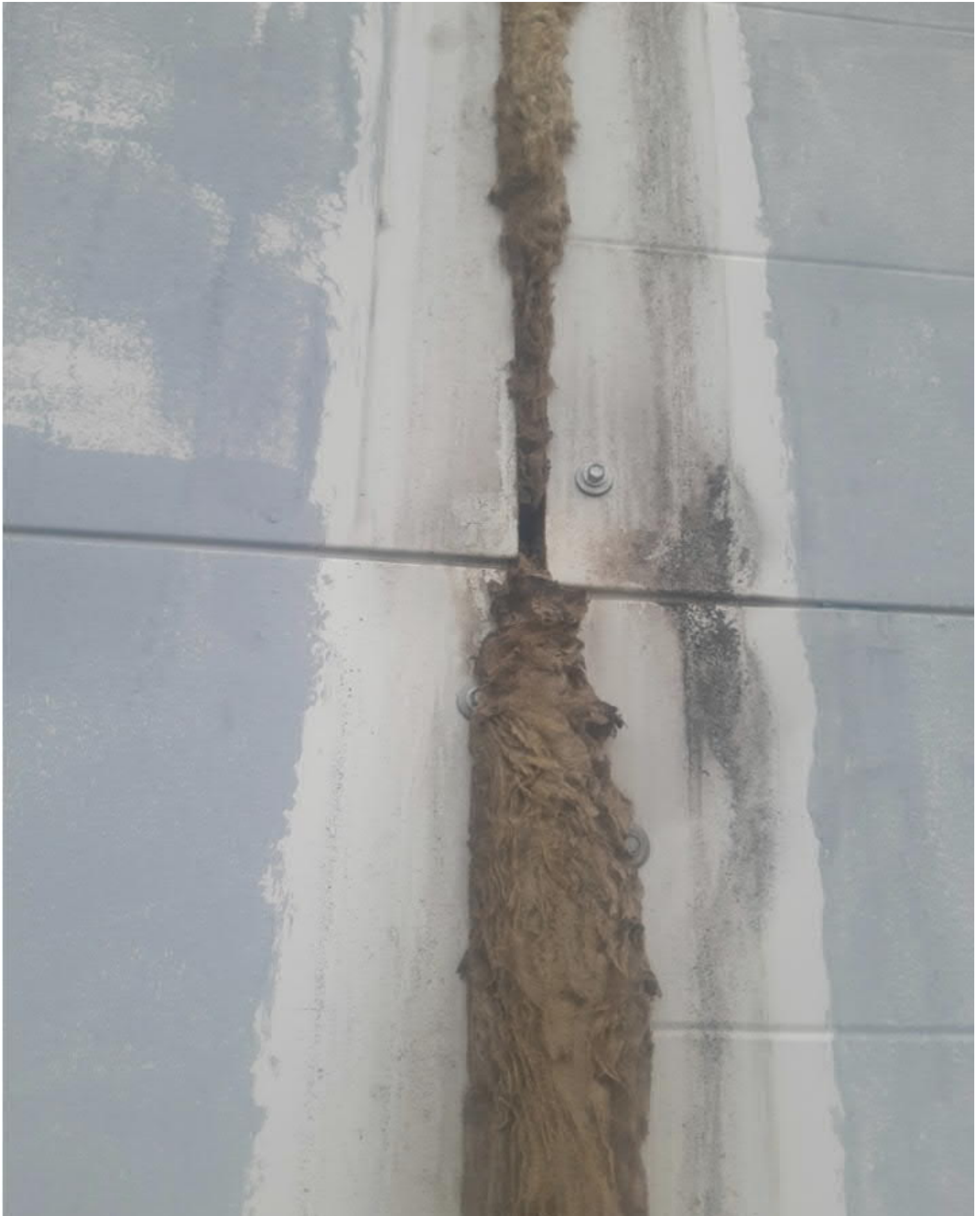
Alkuperäinen elementtisauma korjaamaton.jpg
